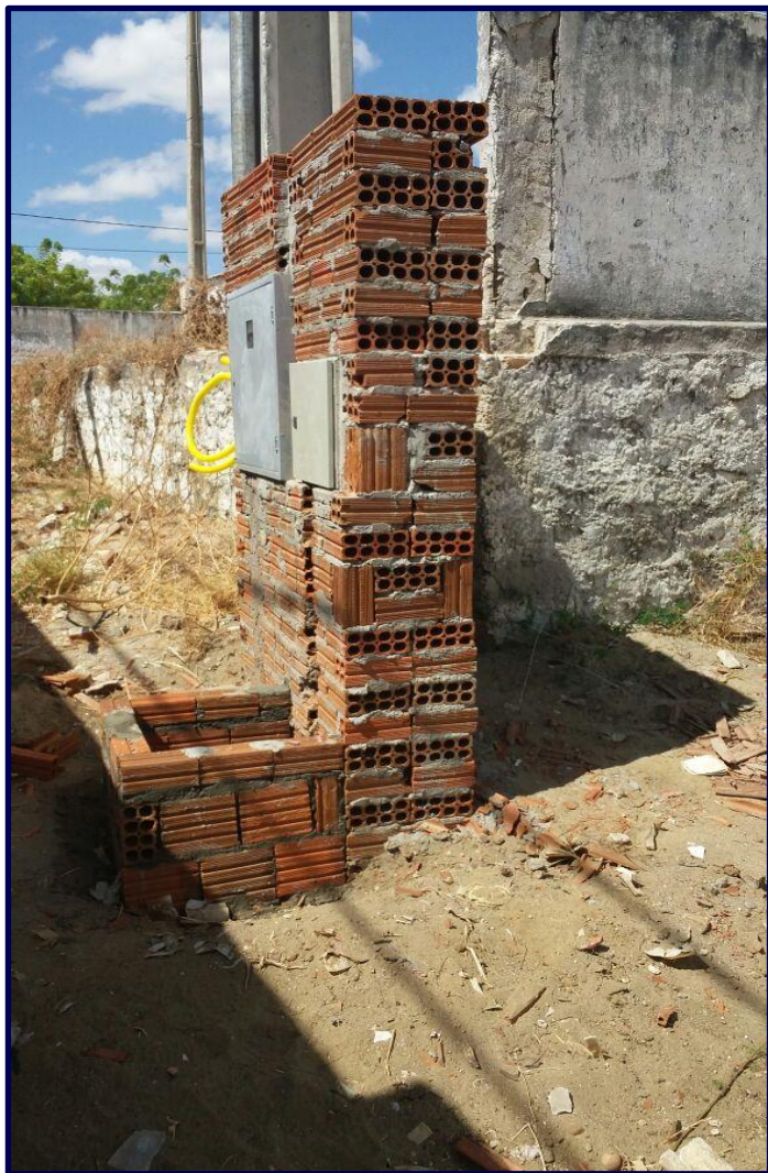
<<<<<< * Mureta em alvenaria para caixa de medição da subestação aérea de 112,5 KVA
